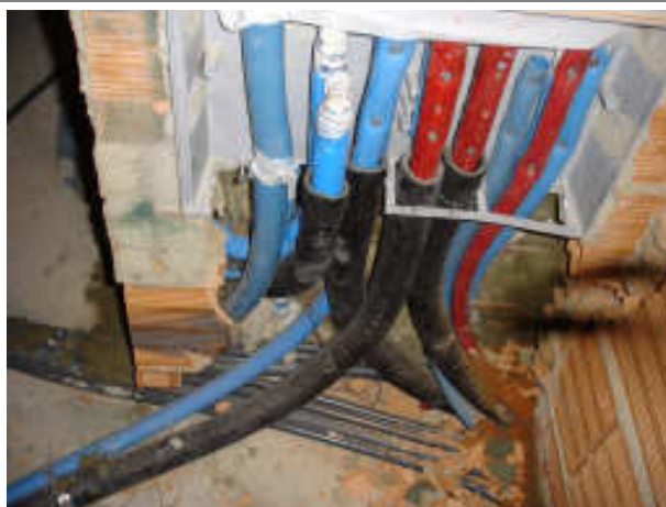
Isolamento térmico nas condutas
