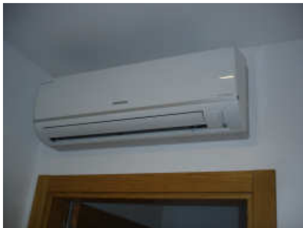
Unidade interior de ar condicionado
